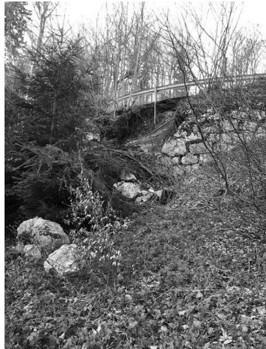
Hangrutsch an der Bergstrasse
